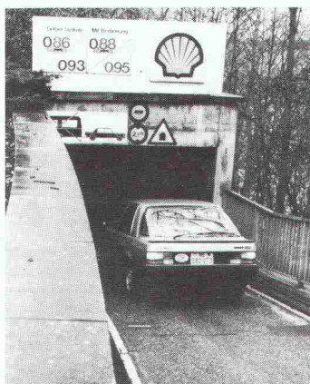
Eindringendes Sickerwasser und eingeschlepptes Tausalz: die häufigsten Schadenverursacher.
