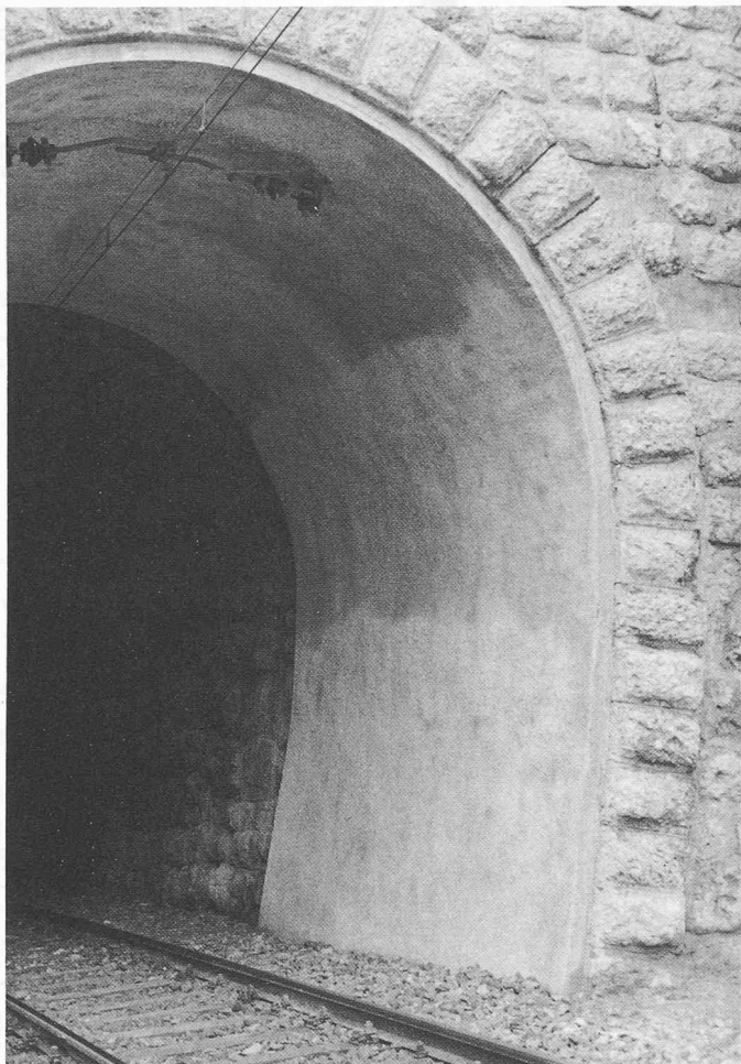
Bild 7. Unterschiedlicher Grauton («Wolkung») nacheinander ausgeführter Spritzbetonflächen
