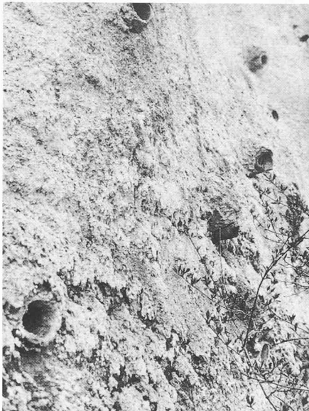
Bild 12. Unansehnliche Spritzbetonoberfläche («Überzähne»)
