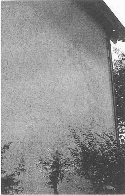
Bild 7. Rötliche Verfärbung eines Silikatputzes durch Einwirkung von alkalischer Feuchtigkeit
