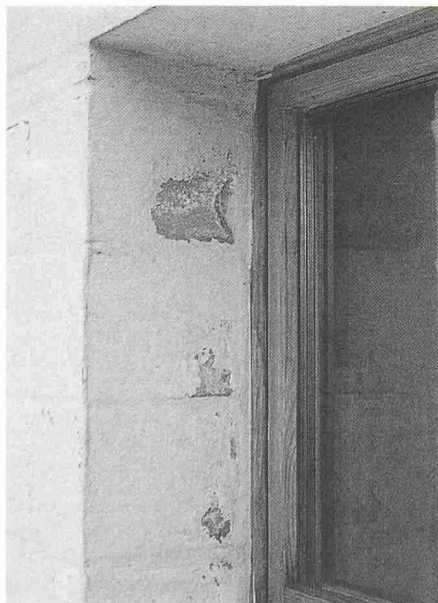
Bild 9. Anstrichablösungen und Ausblühungen auf einem Kalksandsteinmauerwerk
