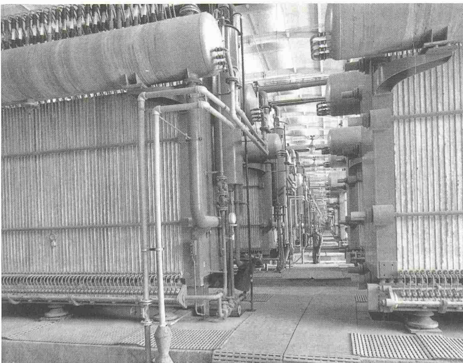
Schweizer Gross-Elektrolyseure zur Erzeugung von Wasserstoff nach der klassischen «alkalischen» Technik (Bild ABB)
