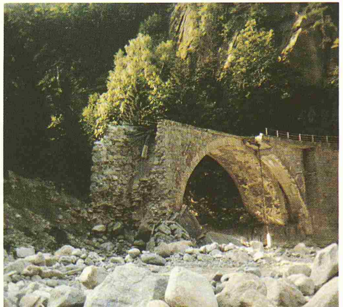
Bild 8. Meienreussbrücke am 25.8. 1987, Flussunterseite, abgebrochene Verbreiterung, aus dem Jahre 1949, bis über den Scheitel zerstörter Betonbogen Bildautor: R. Kalbermatten
