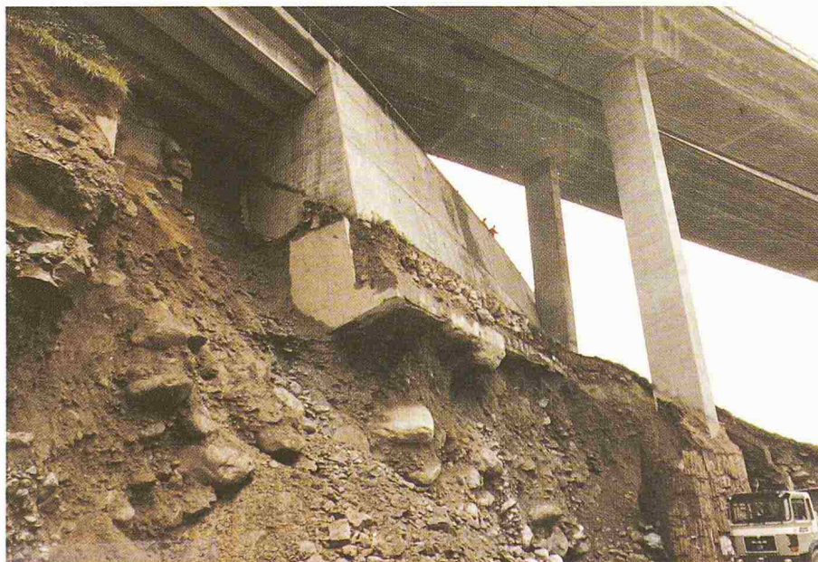
Bild 7. Untersicht des unterspülten und freigelegten Fundamentes der Stützmauer und des Widerlagers des Lehnenviaduktes Kantonsstrasse Bildautor: T.R. Schneider, 1878/12, 1878/19
