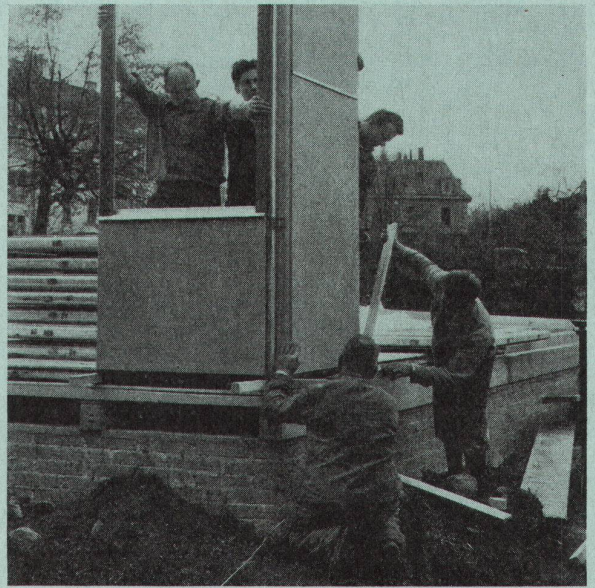
Das Trelement-Haus in der Montage. Architekt: Eberhard G. Rensch, Frankfurt am Main
