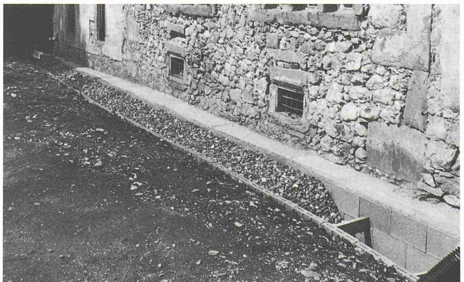
Bild 23. Dieselbe Mauer nach der Sicherung mit Fliessbeton (Bindemittel Hydraulischer Kalk HK). Sickerplatten, Sickerpackung und Drainage schützen vor Feuchtigkeit. (Winkelriedhaus Stans 1987)
