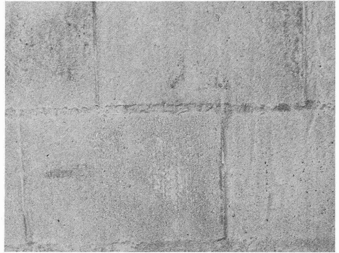
Bild 11. Dieser «Zementanwurf» gleicht eher einer Glasur. Die dünne, feinkörnige, mit zuviel Wasser angemachte Mörtelschicht «verdurstete» auf dem stark saugenden Backstein und konnte nicht voll erhitzen
