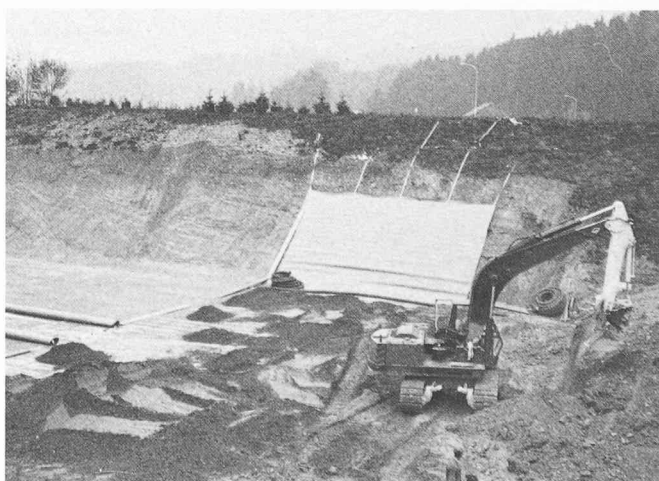
Fig. 4. — Après la pose des feuilles d'étanchéité synthétiques, tout en les remontant le long des talus, y compris la fixation suivante, une couche de sable de 20 cm d'épaisseur est mise en place avec des machines comme couche protectrice mécanique pour les feuilles de l'étanchéité. Les tas de sable éparés avant la pose de la couche de sable servent à charger les feuilles d'étanchéité synthétiques.
