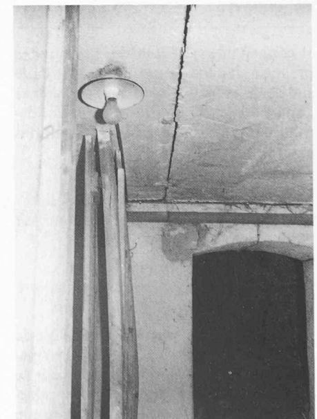
Fig. 4. Déformation des cloisons de séparation et fissuration au plafond d'une des caves
