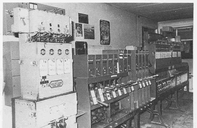
Bild 4. Stellwerk II (Signum Bauart J), mit Stationsblockeinrichtung Hasler
