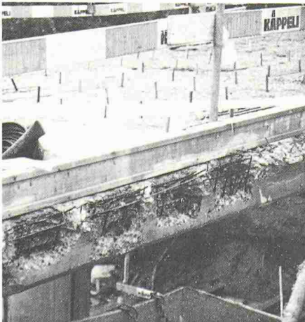
Bild 8. Enge Platzverhältnisse auf der Bankettseite
