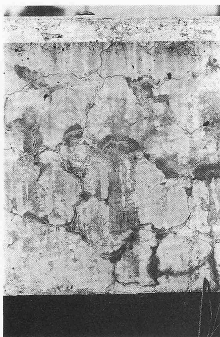
Bild 23. B-731. Netzartige Risse an der Aussenseite des Konsolkopfes. Zustand 1980
