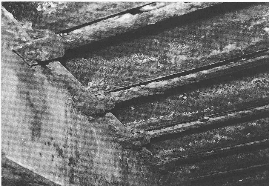
Bild 9. B-001, Verrostete Zoreisenfahrbahn. Untersicht, mit Längsträger (links)
