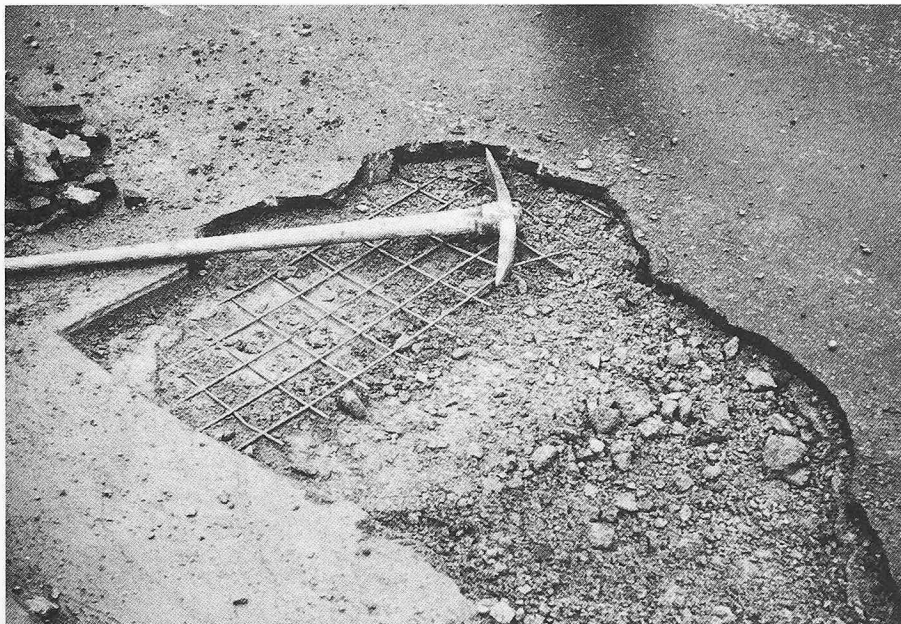
Bild 19. B-058 Reussbrücke Gebenstorf. 1976 mussten Schäden an der Stampfbetonplatte aus dem Jahre 1930 notdürftig geflickt werden. Dies löste umfangreiche Untersuchungen der Brücke und ihrer Fundationen aus...
