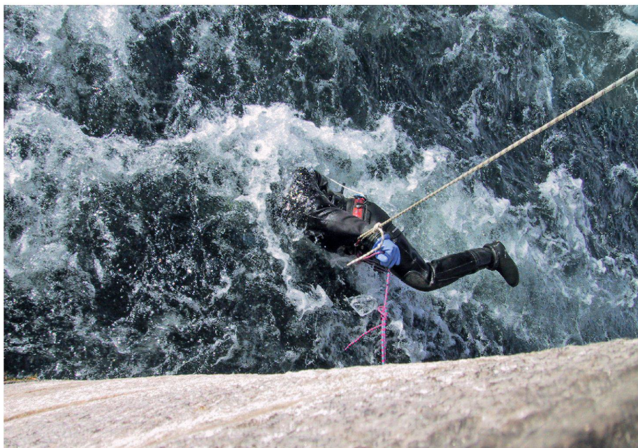
01 Urs Tappolet während einer Schadensanalyse an einem Pfeiler der SBB-Bogenbrücke bei Laufen am Rheinfall (Foto: Staubli Kurath und Partner AG)
