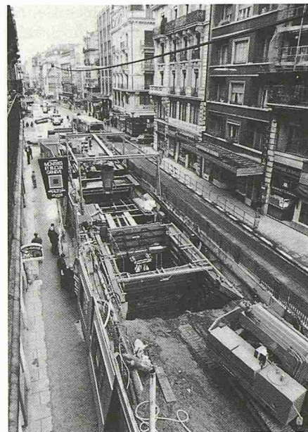
Bild 4. Bau eines Leitungskanals in einer Geschäftshauptstrasse unter Aufrechterhaltung des öffentlichen Verkehrs und Gewährung des freien Zugangs zu den Geschäftseingängen
