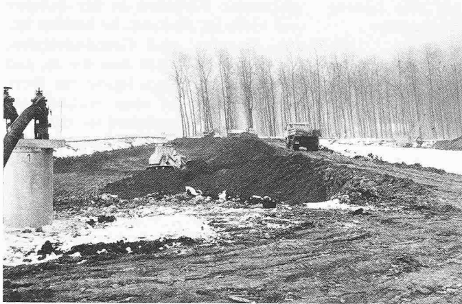
Bild 2. Fundationsarbeiten in der zukünftigen gesicherten Deponie in Collombey-Muraz. Vor dem Einbau der verschiedenen Dichtungsschichten musste der Boden durch eine Grundwasserabsenkung stabilisiert werden
