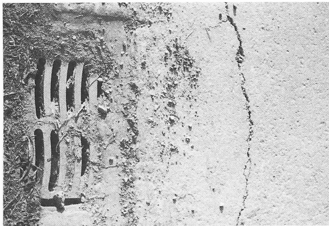
Bild E1. Sichtbar: gerissener Walzasphalt
