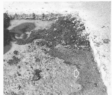
Bild B4. Probe 1: Der Belag ist entfernt. Die Abdichtung ist mit einer anhaftenden Betonschicht von bis zu 8 mm herauslösbar. Der linke und der rechte Rand der Abdichtung haften wieder fest an und mit dem Beton (Pfeil). Am tiefsten Punkt stehendes Wasser
