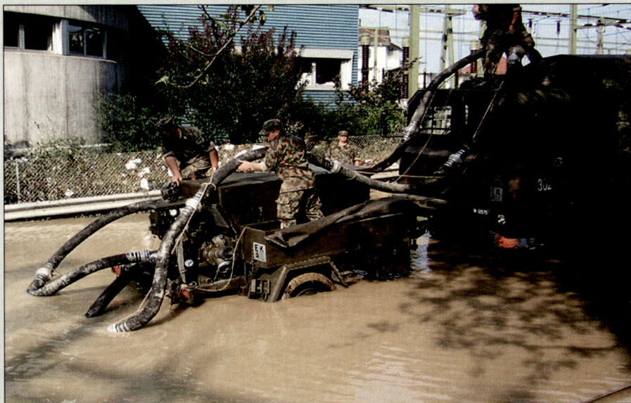
Löschwasserpumpen im Einsatz.
