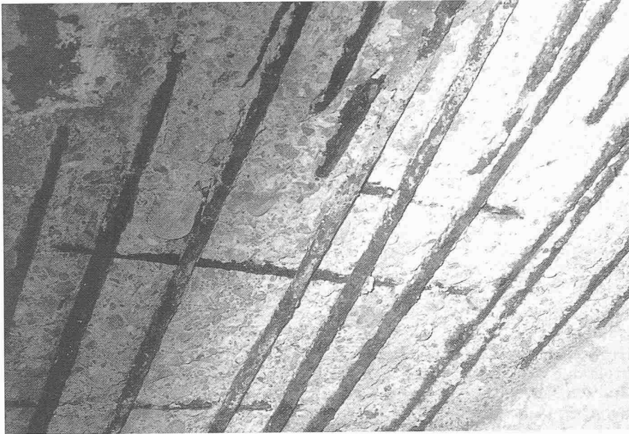
Bild 1. Korrodierte Bewehrungsstähle haben die Betonüberdeckung abgesprengt
