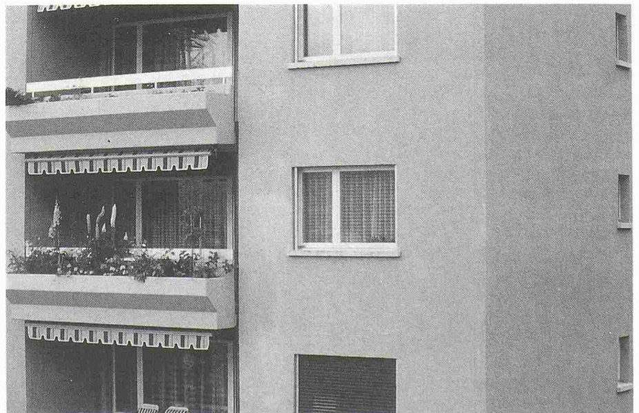
Bild 6. Kalkausblühungen (weisse Flecken) an der Deckputzoberfläche eines mineralischen Putzes mit einem Mineralanstrich. Die Ausblühungen sind eine Folge der zu hohen Mauerwerksfeuchtigkeit vor den Verputzarbeiten
