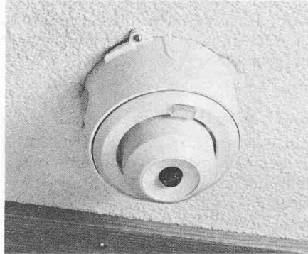
Bild 9. Der gleiche Melder, knapp über dem Boden montiert, um schwere Gase wie Propan usw. anzuzeigen
