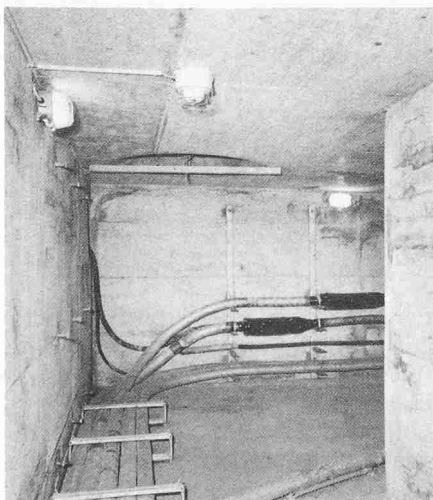
Bild 10. Ein Melder überwacht das Eindringen von Erdgas in einen Kabelkeller
