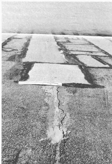
Bild 6. Erneuter Riss im mit Matrix geflickten Dichtungsbelag, Überbrückung durch die Polymer-Bitumen-Dichtungsbahn (PBD). Die PBD wurde bewusst nicht bis ganz hinaufgezogen
