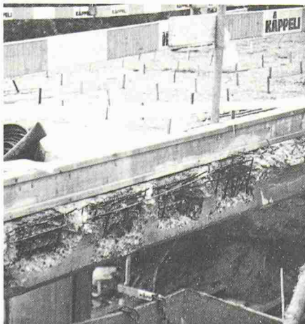
Bild 8. Enge Platzverhältnisse auf der Bankettseite
