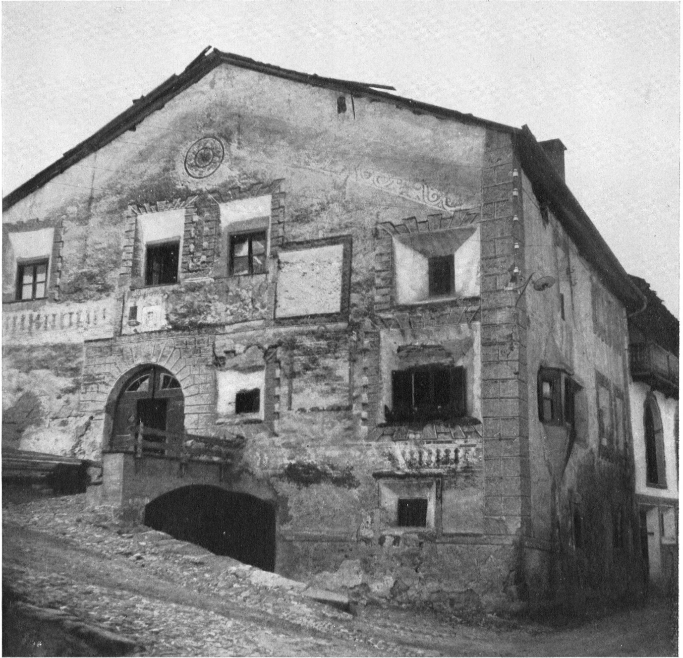
Ardez im Unterengadin. Zerfallenes Haus mit Sgraffittoschmuck. Allein in Ardez befinden sich mehrere Häuser dieser Art in ähnlichem Zustande. Ohne Hilfe können die unbemittelten Besitzer sie nicht in Ordnung bringen lassen. Cette maison d'Ardez (Basse-Engadine) fut agrémentée de sgraffittes. Mais elle n'est pas la seule à connaître la misère. Les propriétaires n'ont pas de ressources; il faut l'Ecu d'or. Ardez nella Bassa Engadina. Casa in rovina con ornamenti in sgraffito. In questa località si trovano parecchie case del genere nello stesso stato. Senza un aiuto dal di fuori i proprietari non sono in grado di pensare ad un riassetto.
