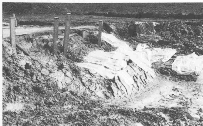
Bild 11. Baugrube Zürich, unmittelbar nach erfolgten Böschungsrutschungen. Man beachte das «Eintauchen» der Böschungsmasse in den Untergrund und die erhebliche rückwärtige Ausdehnung der Instabilität
