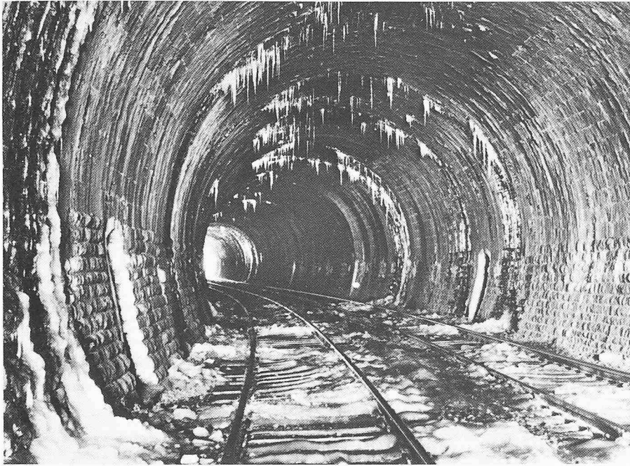
Bild 1. Älterer Eisenbahntunnel vor der Instandsetzung
