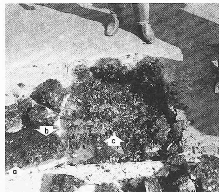
Bild B3. Probe 1: Der WA-Belag (Belagsstärke 11 cm) ist an der Unterseite ausgewaschen (a). In Bruchflächen löst sich die Bitumenhaut vom Splittkorn (b). Auf der Abdichtung liegt ausgewaschener Splitt und stehendes Wasser aus dem Belag (c)
