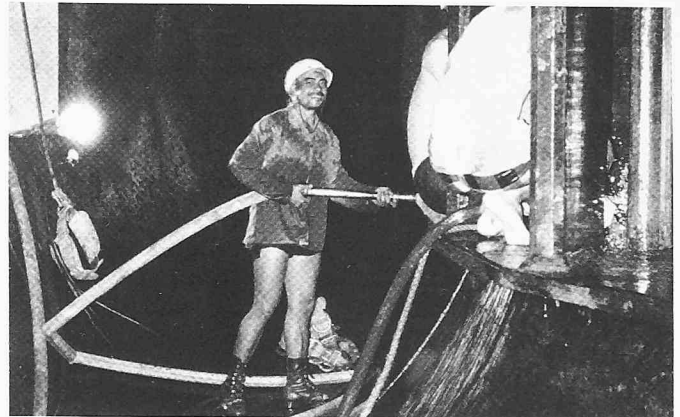
Bild 25. Arbeiten im Innern einer Francisturbine mit unzulässigen mobilen Beleuchtungseinrichtungen von 220 Volt; Einrichtungen mit Kleinspannung fehlen hier
