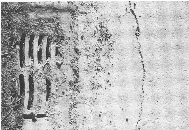
Bild E1. Sichtbar: gerissener Walzasphalt
