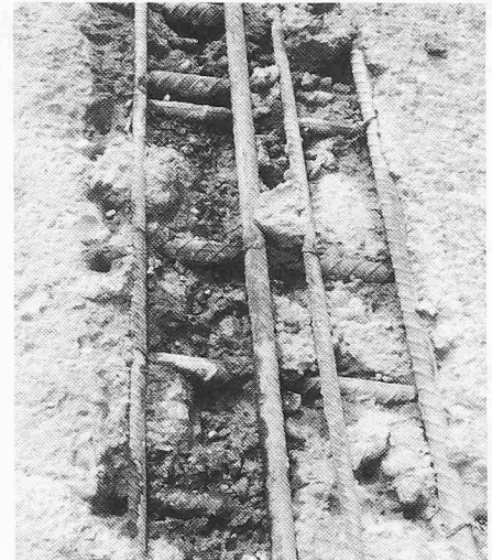
Bild D2. Beim Öffnen des Belages zeigte sich ein feuchter Riss im Beton. Etwa 3 mm unter der Betonoberfläche befand sich reiner Kies. Die sichtbare obere Hauptarmierung war nicht gerostet – die Entstehungsgeschichte ist unklar
