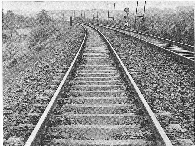
Bild 2. Die Schwelle B55 in einem Gleis der DB
