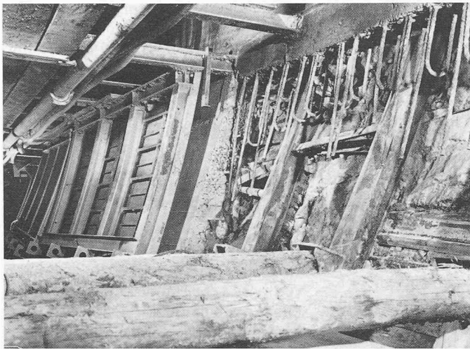
Bild 7. Betonieren der Paramente. Links: deformierte Einbaubogen, abgestützt mit Rundholzspriessen. Unten: Anschlusseisen für obere Paramentetappe. Rechts: fertig betoniertes Parament, davor Schalelement.
