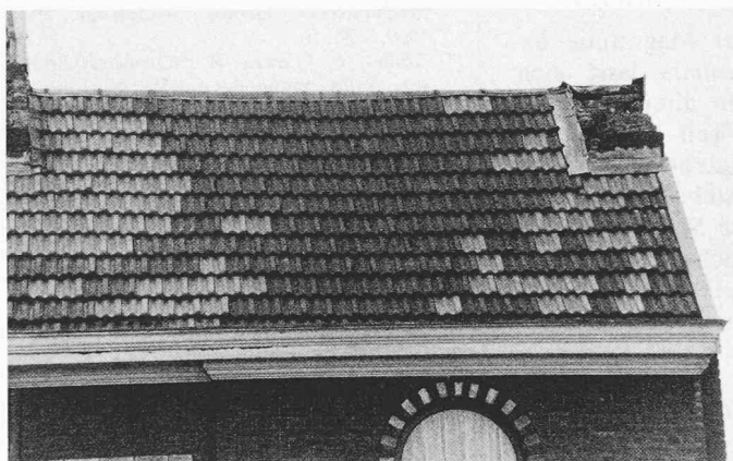
Bild 9. Dach mit zerstörten Kaminen. Die hellen Partien zeigen das Ausmass der zerstörten Dachziegel. Beide Kamine sind in die gleiche Richtung gefallen (E-W)
