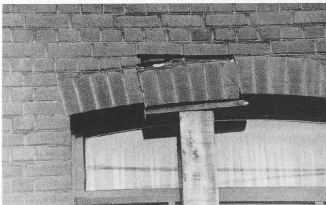
Bild 10. Nach unten verschobener Teil eines Fensterbogens. Deutet auf starke vertikale Beanspruchung hin
