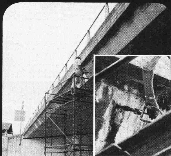
Risse in Betonbauwerken Abdichtung mit Renesco-Flexin-Injektionen
