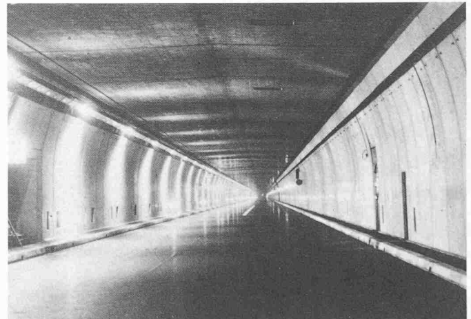
Bild 3. Notbeleuchtung mit eingeschalteter Brandnotbeleuchtung
