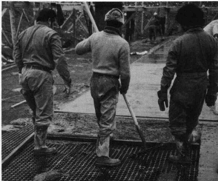
Bodendrainage, ausgeführt in den Kernkraftwerken Gösgen und Leibstadt – Schweiz
