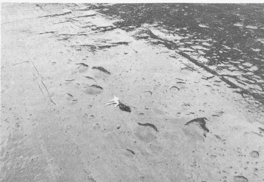
Bild 3. Blasen unter einer kunststoffmodifizierten Bitumenfolie
