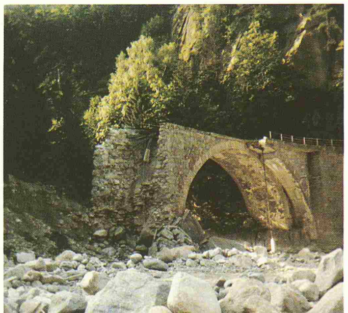
Bild 8. Meienreussbrücke am 25.8. 1987, Flussunterseite, abgebrochene Verbreiterung, aus dem Jahre 1949, bis über den Scheitel zerstörter Betonbogen Bildautor: R. Kalbermatten
