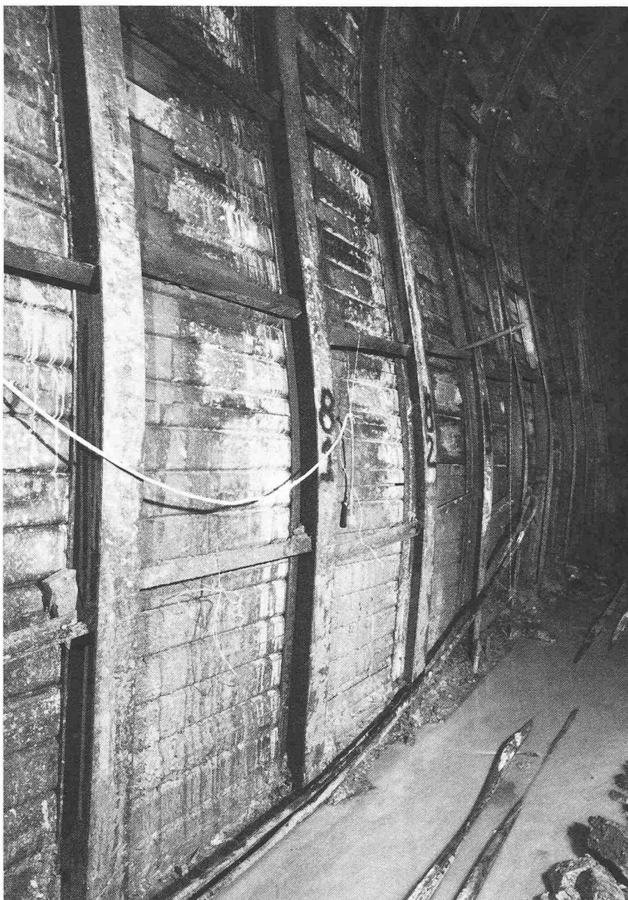
Bergdruckerscheinungen an Stahleinbauten. Die Verformungen erreichen stellenweise 40 bis 50 cm
