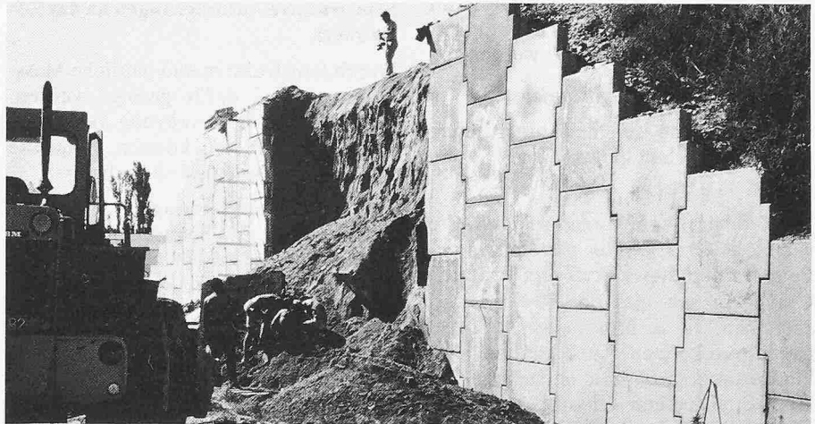
Bild 20. Versuchsbauwerk aus bewehrter Erde. Die speziell dünne Bewehrung wurde für eine Lebensdauer von 8 Monaten ausgelegt. Nach 9 Monaten ist das Bauwerk zusammengebrochen
