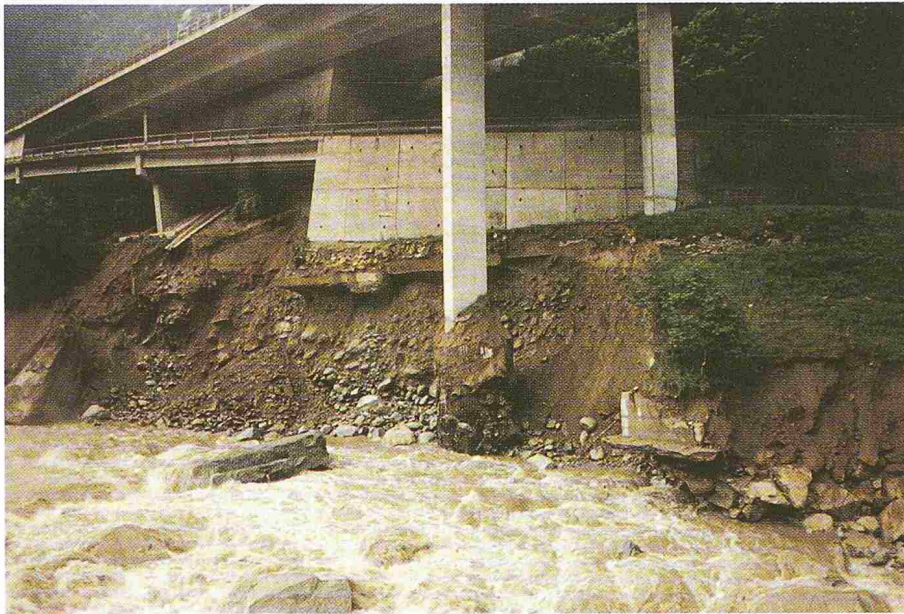
Bild 4. Absenkung Reussbrücke und freigelegte Fundationen von Pfeiler I und Stützmauer der Kantonsstrasse Bildautor: T.R. Schneider
