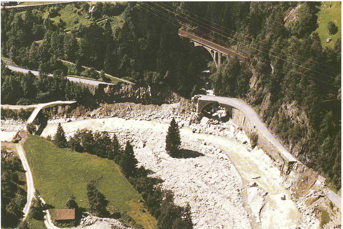
Bild 1. Zerstörte Gotthardstrasse im Bereich der Meienreussbrücke in Wassen (Foto Bauamt Uri)
