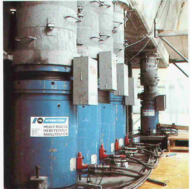
Insgesamt 16 solcher Hydraulikpressen, je 8 mit einer Tragkraft von 350 bzw. 200 t, sind nötig, um den 560 t schweren Brückenteil ausbalanciert zu heben. Im Hintergrund ist einer der bei der Absenkung entstandenen Risse zu erkennen.
