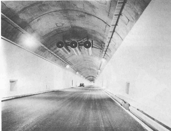
Bild 4. Strahlventilatoren im Haupttunnel Richtung Luzern
