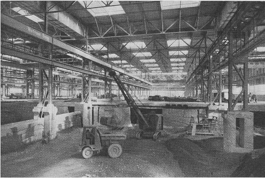
Bild 14. (links) Nachträglicher Aushub für Unterkellerung und für Maschinenfundamente. In der Stützenaxe links erkennt man die Kanalisation (Kanalisationsaxe), in der Axe rechts die Öffnung im Stützenfundament zur Aufnahme von Installationen
