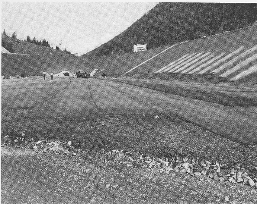
Fig. 23. Bassin de compensation de Motec. Revêtement du bassin, couche filtrante, couche drainante, béton bitumineux
