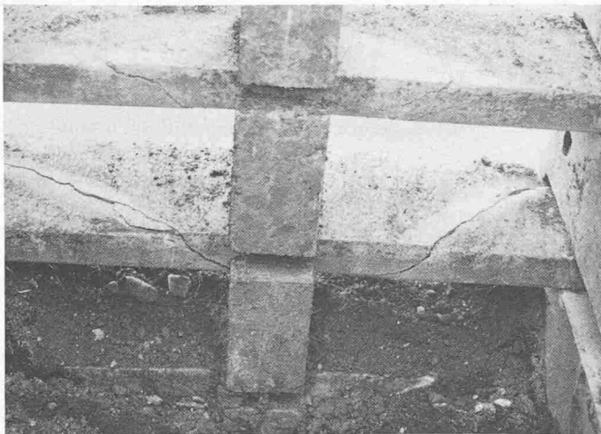
Bild 4. Typischer Läuferschaden. Torsionsrisse als Folge einer übermässigen Mauerbeanspruchung bei gleichzeitig ungünstiger Läuferlagerung
