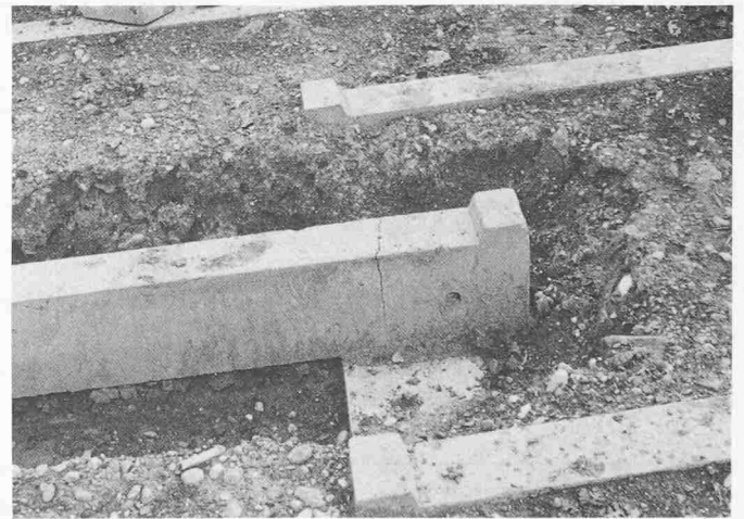
Bild 5. Typischer Biegeriss im Auflagebereich des Rucksackbinders als Folge der stark ungleichmässigen Lagerungsbedingungen dieser Binder
