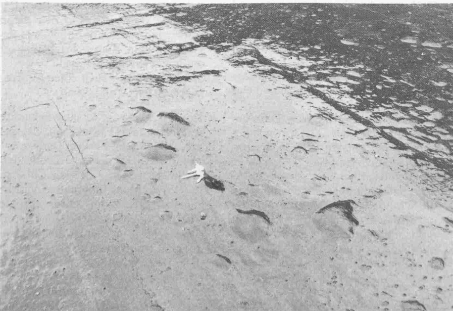
Bild 3. Blasen unter einer kunststoffmodifizierten Bitumenfolie
