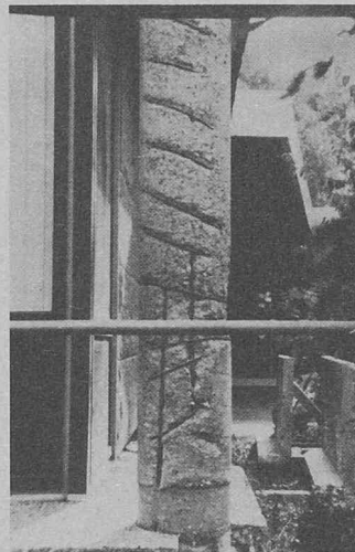
Bild 1. Ernsthafte Betonschäden am Verwaltungsgebäude eines Industrie-konzerns. Schon vor vier Jahren war erfolglos versucht worden, die Stahlbeton-Rundsäulen zu retten
