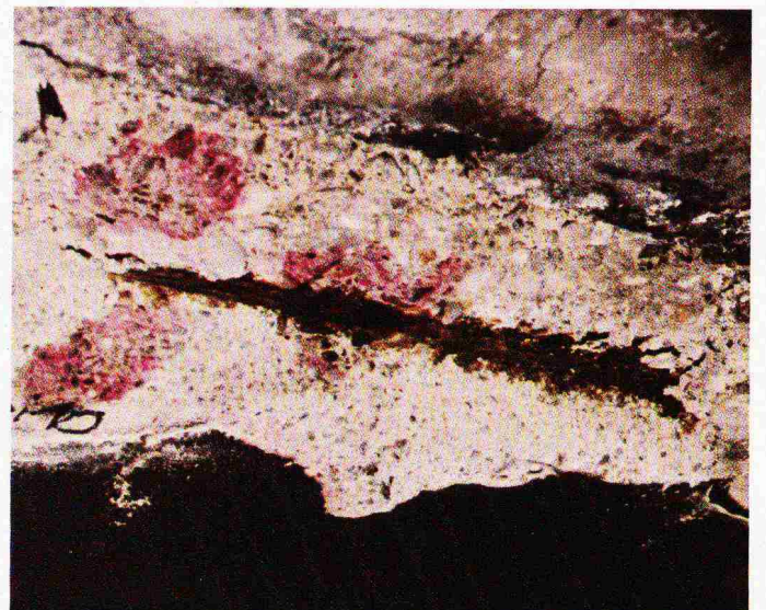
Brücke C. Die Resthaftung (rote Zone) dieser abgedrückten Betonüberdeckung war die Ursache, dass dieser Zustand bis zum Tage der Untersuchung unbekannt blieb
