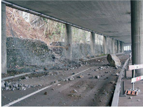
Felssturz im Oktober 2009 (Foto: Astra)
