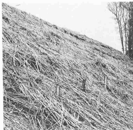
Bild 15. Kerzers N1, Mühle Grau. Die geschüttete Kiesböschung wurde mit Steckhölzern vernagelt, hinter welche Weidenstämme gerollt wurden; die Fläche wurde mit Schilf abgedeckt. (Stabilbauweise)
